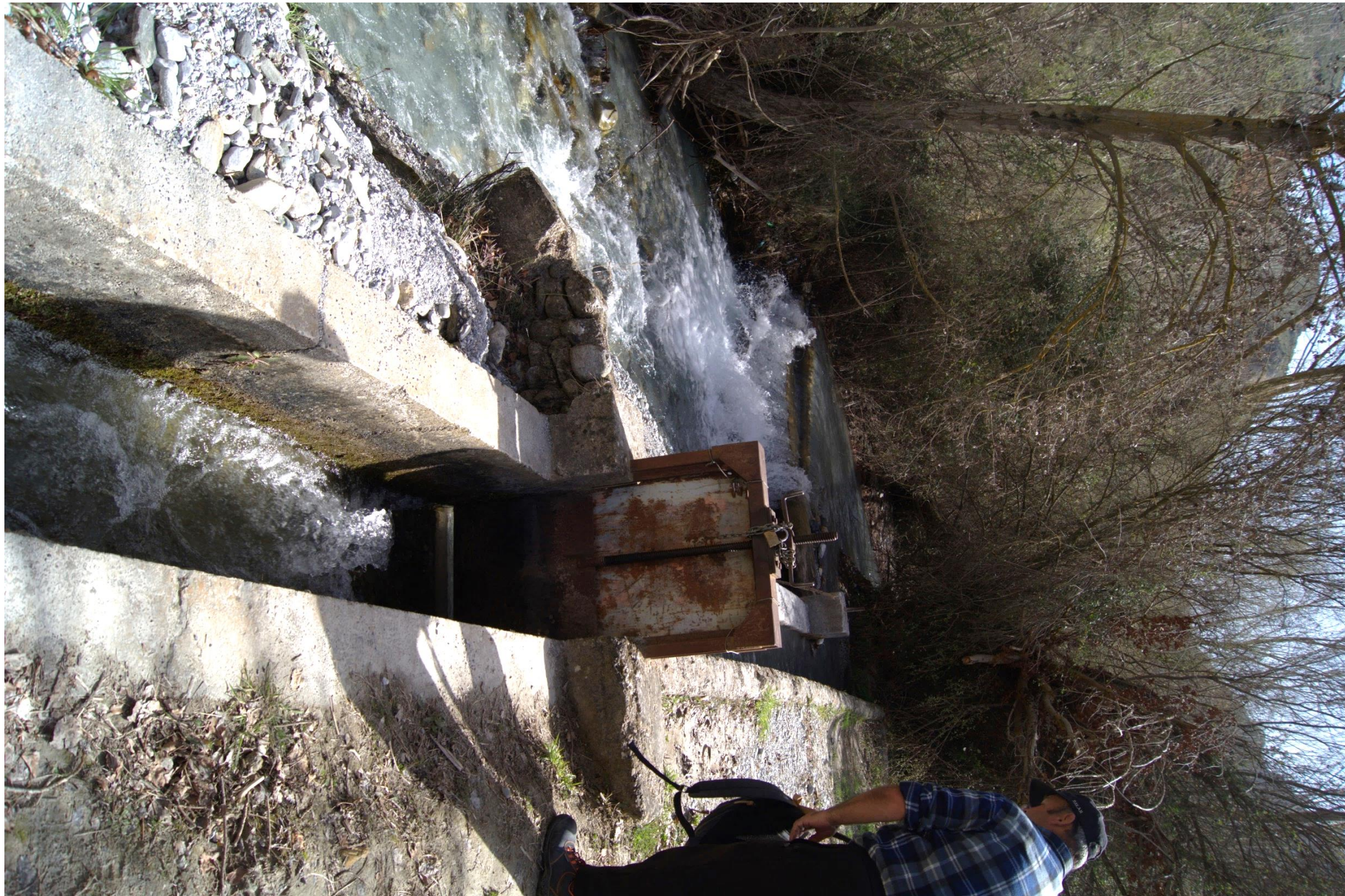
Fig. 13: compuerta de toma de la acequia Baja. Los Juncare.
