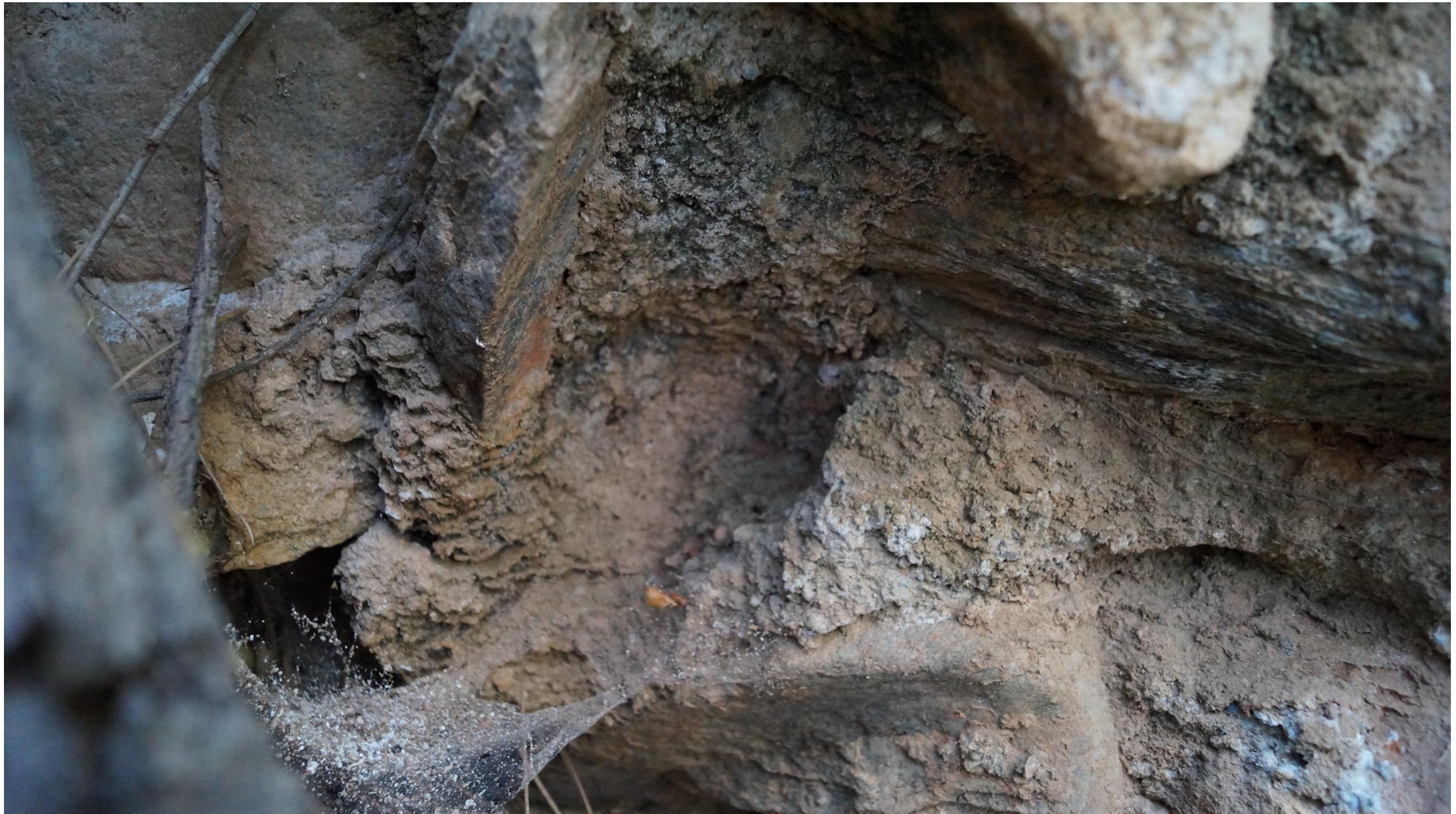
Fig.29: detalle de fábrica y mortero en zona afectada donde se ha caído el hormigón. Acueducto en la acequia Alta
