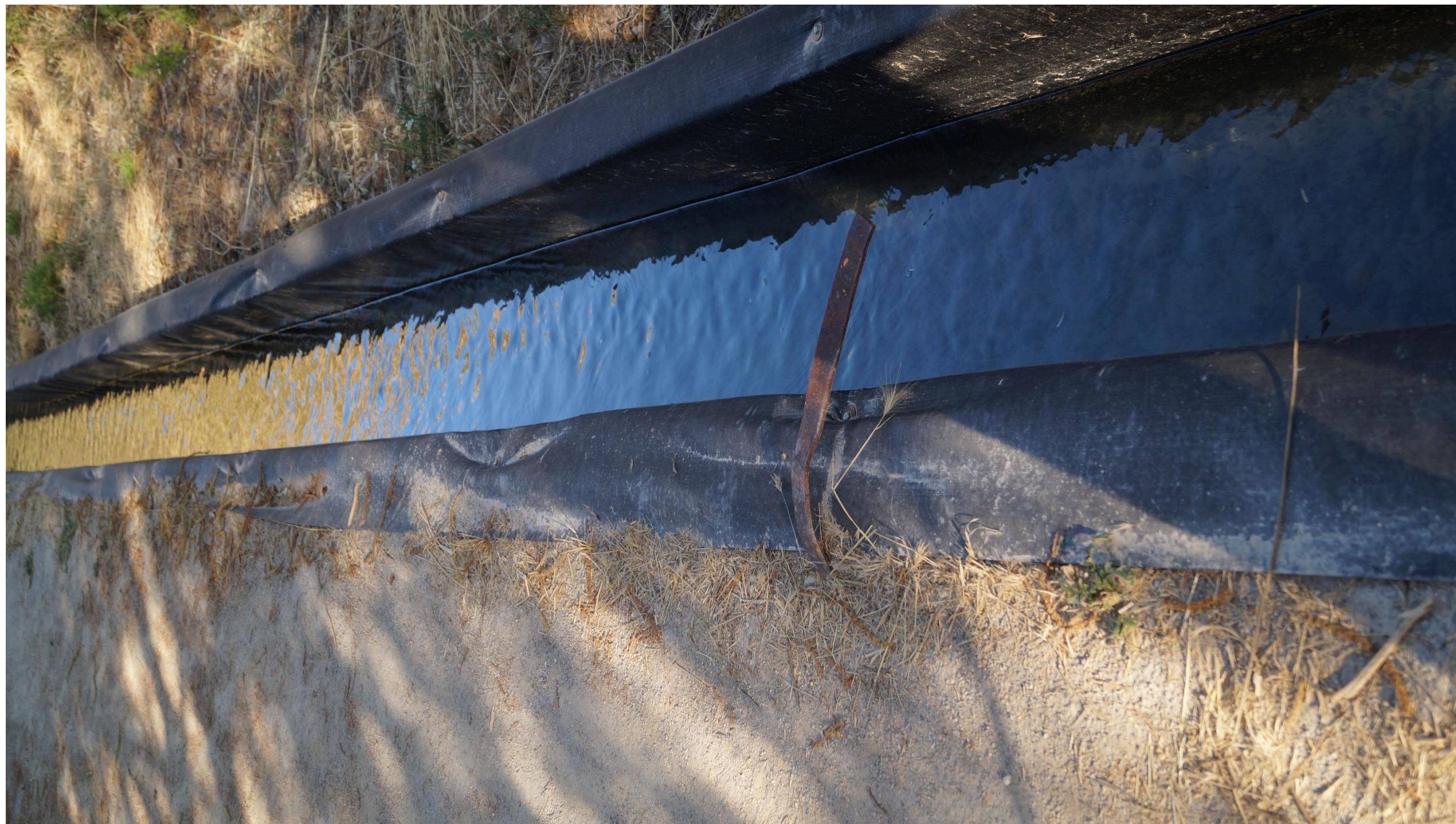
Fig. 48: elementos metálicos sobresalientes en pago de La Hoya
