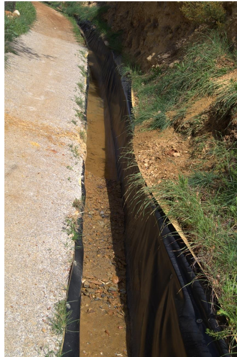
Fig. 56: deterioro en tramo de la acequia.
